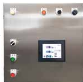
制御パネル (タッチパネル仕様)
